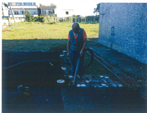
定期檢查污水系統
