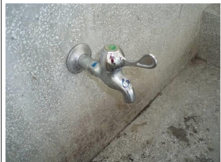
說明：水龍頭安裝省水裝置，建立永續校園基礎
