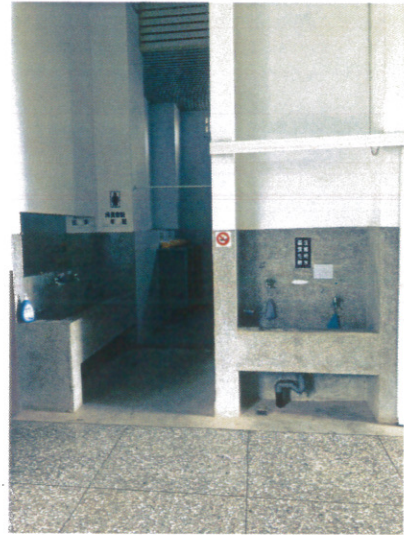
有充足的洗手設備
